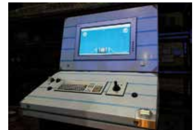
Monitor del sistema DAM en la sala de control.
