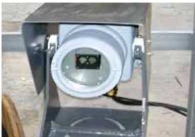
Sensor laser del sistema DAM instalado en el puerto.
